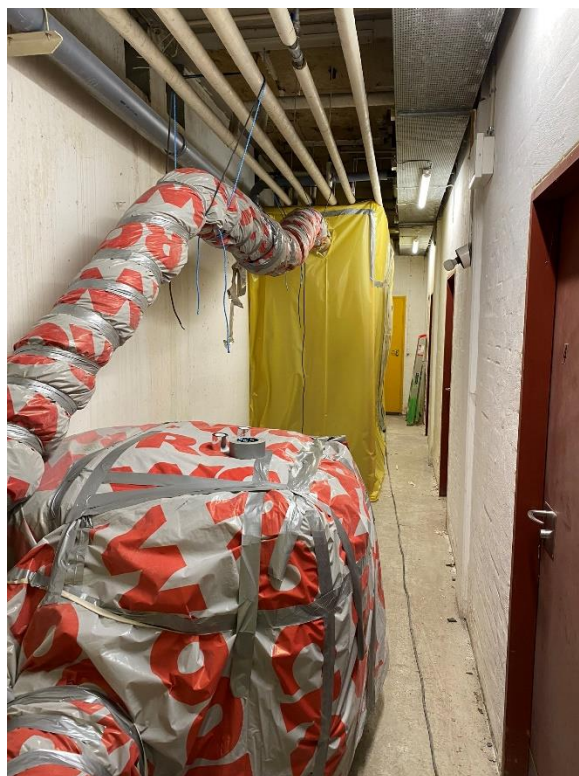
Figur 4. Opstilling med lufttæt rum og isoleret filter
