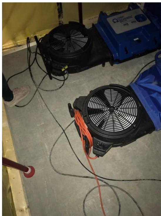
Figur 2. Booster til opvarmning af Drymatic væg
