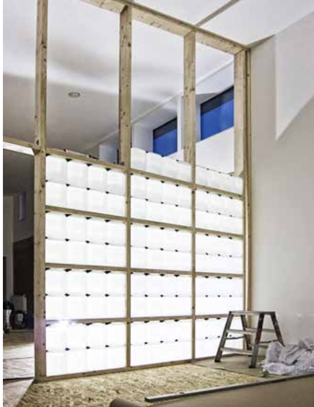
Skillevæg med termisk masse af genbrugte plastikdunke.
