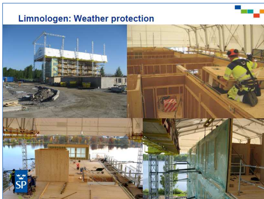
Figur 3: Eksempel på hvorledes et tørt byggeri kan sikres, når der benyttes fugtfølsomme elementer. Præsentation fra temadagen "Gentænk træ som bærende bygningsdele i høje bygninger", Pierre Landel, SP Wood Building Technology
