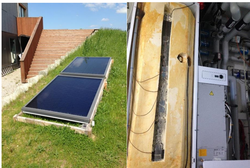
Figur 12 Solfangere placeret på jord af praktiske årsager (tv.) og Figur 13 varmtvandsbeholderen inde med termoelementer placeret i beholderens højderetning (th.). Under forsøg genetableredes den manglende isolering og kabinettet lukkedes.
