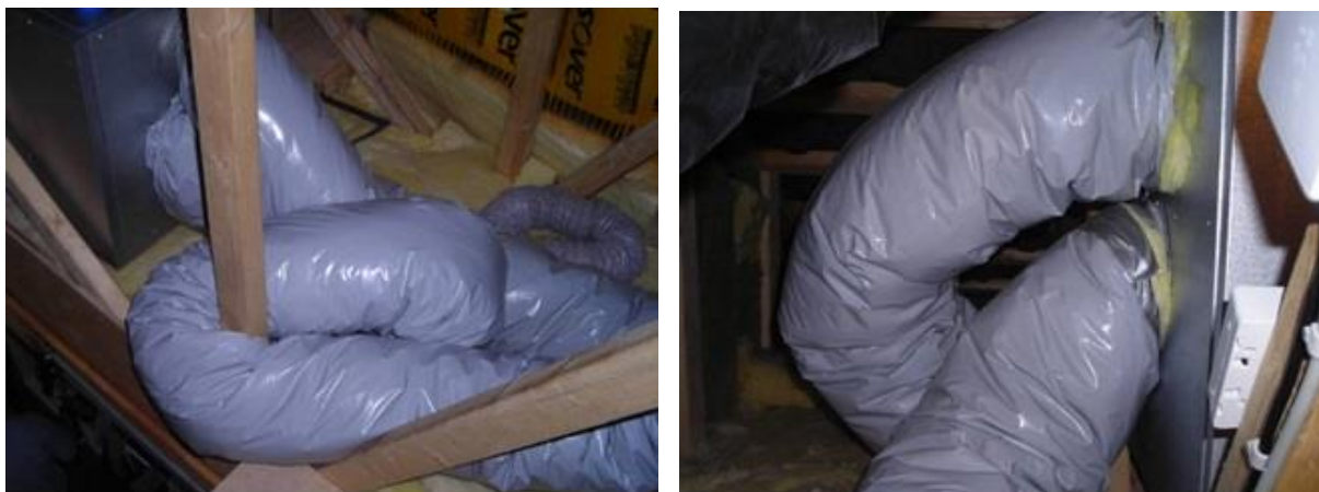
Figur 6 og figur 7 Sådan skal et kanalsystem IKKE udføres. Eksempel fra dansk nybyggeri. Tryktabet vurderes at være 15 gange større end det behøver at være.
